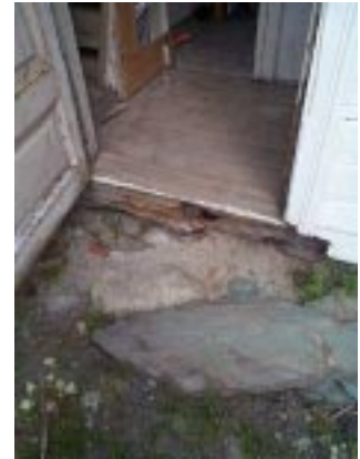
Råteskadd bunnkarm mot sør. Foto 2000
