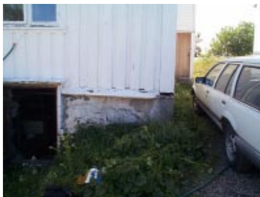
Bygningen har en setning i det NV hjørnet. Foto
